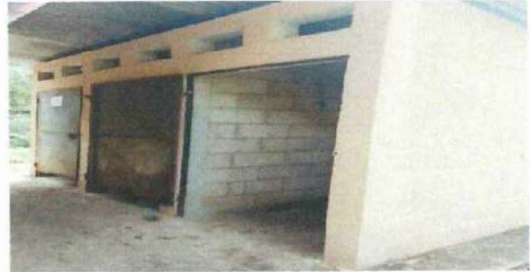
Foto 2: Las puertas del baño se necesitan cambiarla ya estan picadas y una letrina sin uso por el mal estado.
