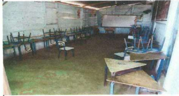
Foto 4: El piso del aula se necesita mejorar, actualmente es rustica guarda polvo no esta alisado.
