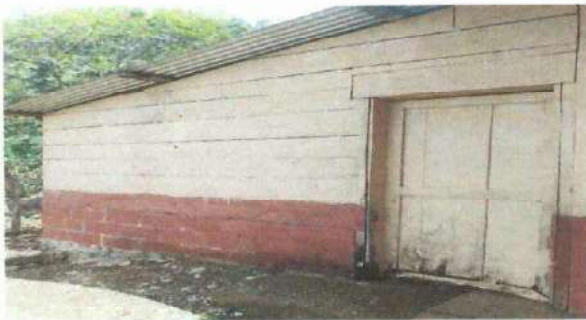
Foto 3: El aula de segundo grado se necesita terminar de block las tablas ya esta en mal estado y cambio de techo las vigas estan llenas de polillas.
