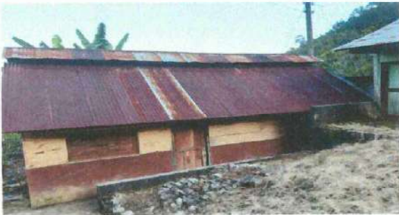
Foto 1: El techo de la cocina esta bien oxidada se necesita cambiar y terminar de block.
